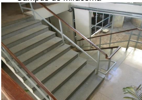
Figura 1 – Escadas para acesso ao piso superior do bloco administrativo – UFT, Campus de Miracema
